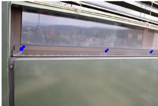
Foto 05: Fehlende oder lose Verschraubung(blau) an Abdeckprofil im Brüstungsbereich
