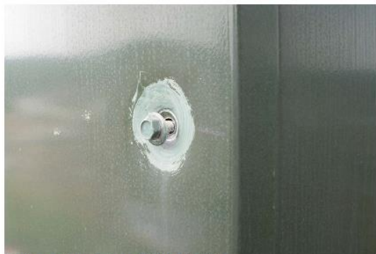
Foto 07: zusätzliche Verschraubungen, Dichtschraube gelöst
