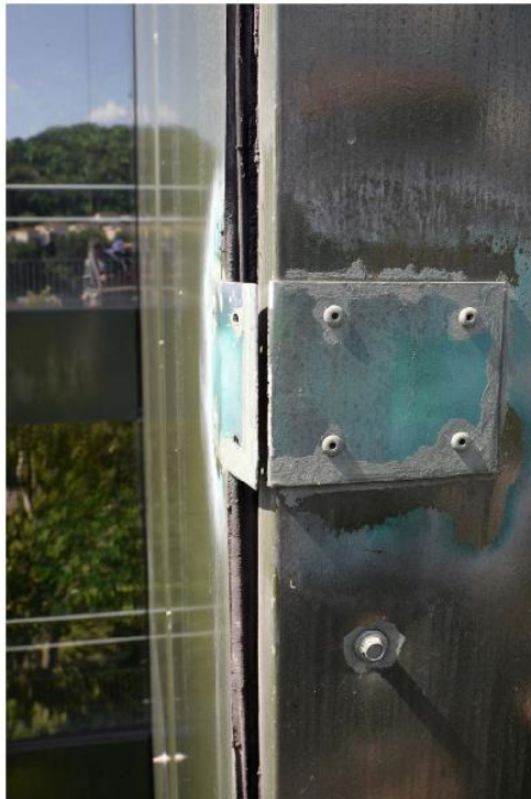
Foto 15: gebrochene Eckverstärkung an Position O 07/11
