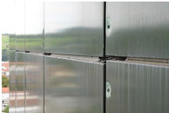
Foto 14: Fugenverlauf mit stark versetzten, nach unten verrutschten Blechpaneelen
