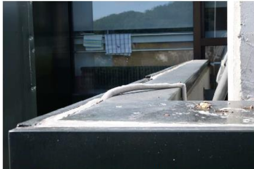
Foto 16: Attikablech 11. OG Ost, Zerstörung der Abdichtung durch Vogelfraß
