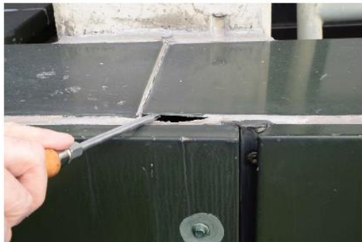
Foto 17: typische Schadstelle an Attikaabdichtung
