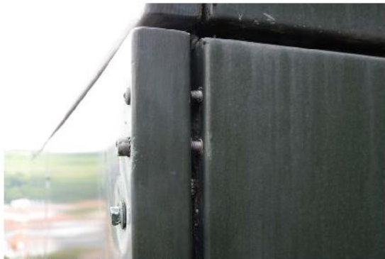
Foto 15: Eckfuge mit unwirksamer zusätzlicher Verschraubung
